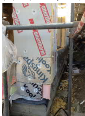
Fot.6. Resztki płyt izolacyjnych.
