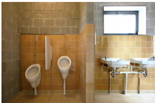
Fot.4. Używane elementy wyposażenia, ceramika sanitarna i armatura
