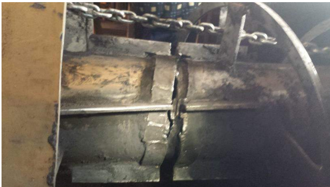
Rysunek 16.3. Układ podawania węgla – przykład uszkodzonego wału naściennego podajnika węgla
