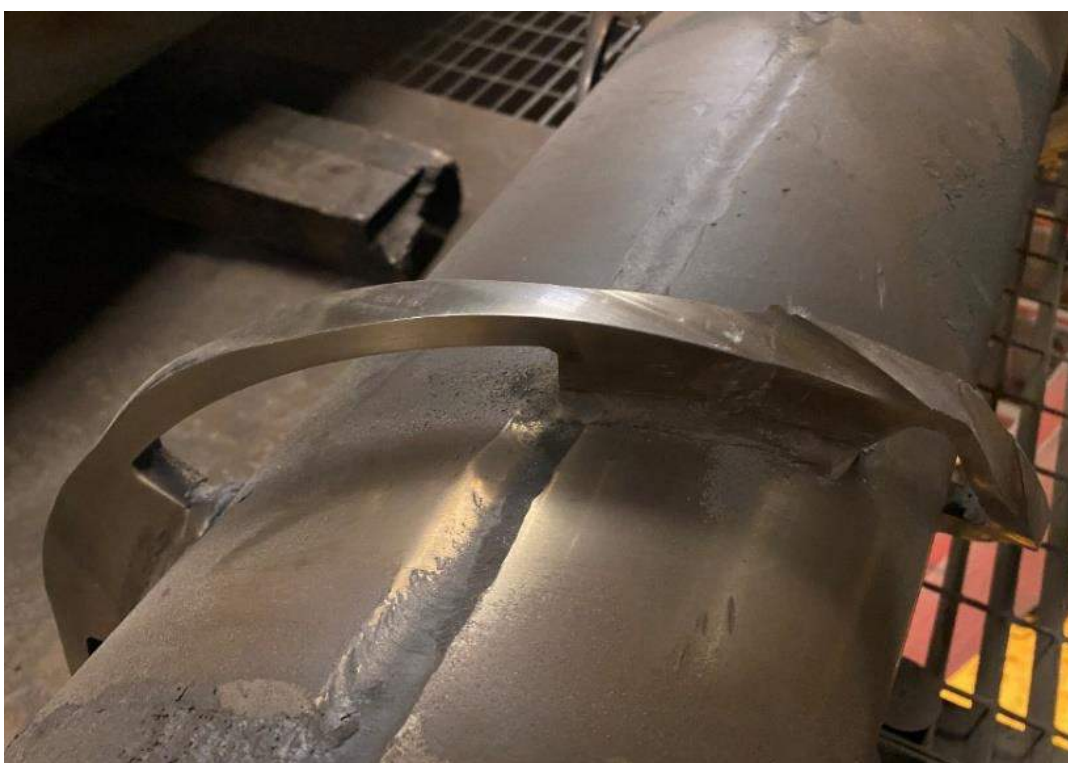
Rysunek 16.6. Układ podawania węgla – przykład erozyjnego uszkodzenia podajnika ściennego
