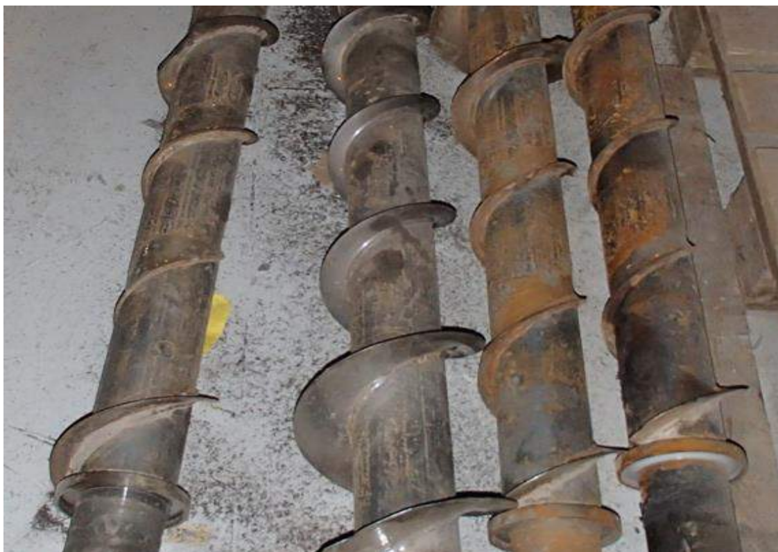
Rysunek 16.11. Instalacja odprowadzania popiołu dennego – uszkodzenia podajników ślimakowych zużyła
