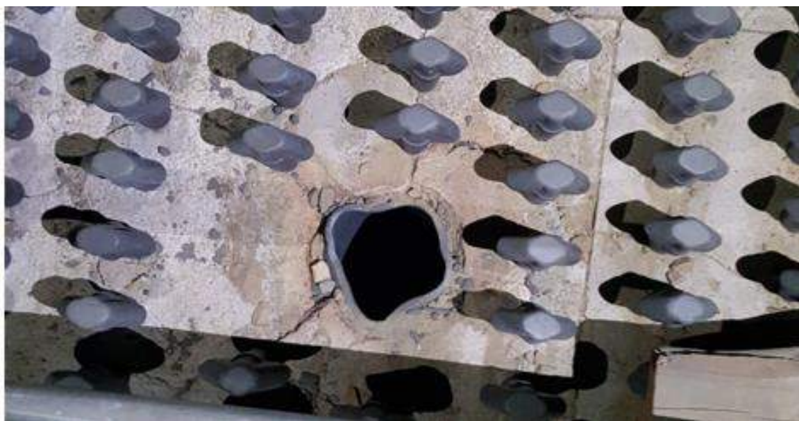
Rysunek 16.10. Komora paleniskowa – odkształcone w wyniku przegrzania zsypy żuźla (duża ilość popiołu zalegająca w złożu fluidalnym utrzymuje wysoką temperaturę w dnie dyszowym)
