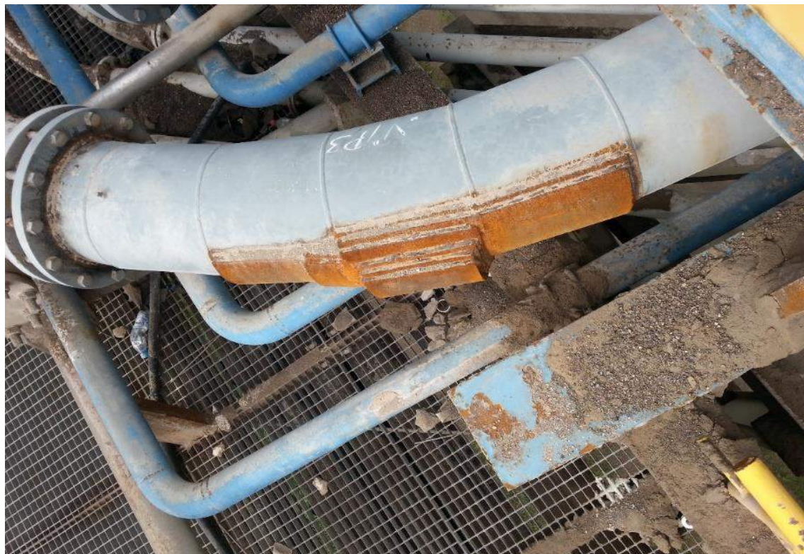
Rysunek 16.13. Instalacja odprowadzania popiołu – wielokrotnie naprawiane uszkodzenia erozyjne
