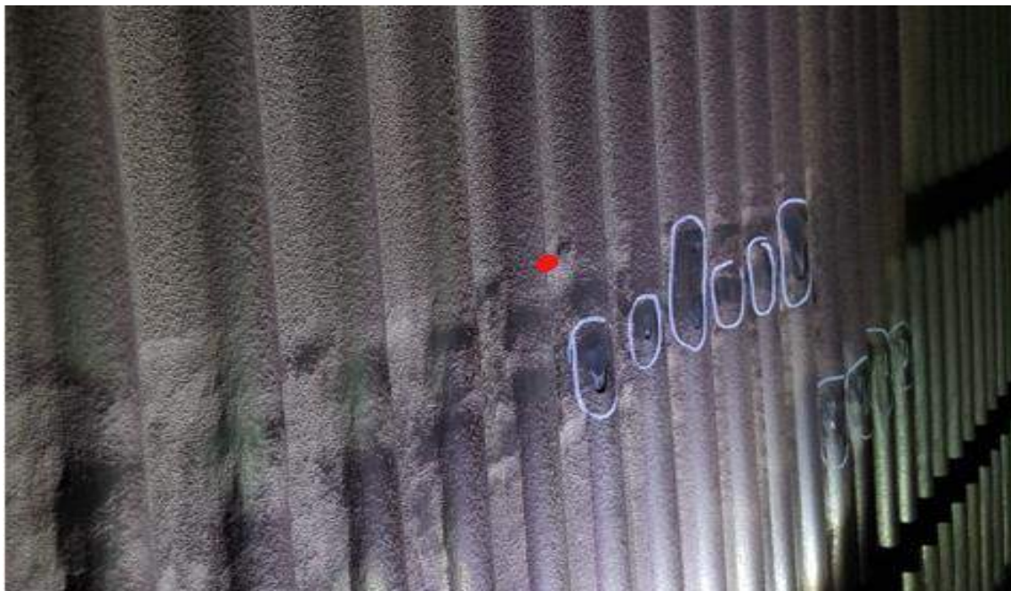
Rysunek 16.7. Komora paleniskowa – przykład erozyjnego uszkodzenia ekranu parownika
