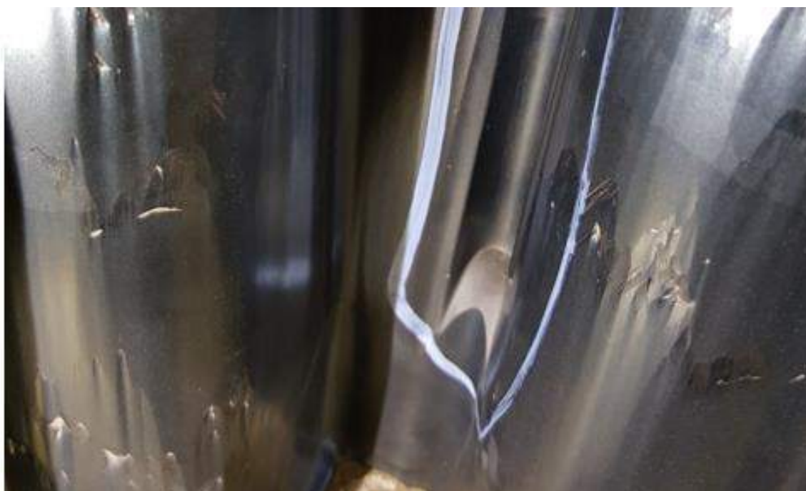
Rysunek 16.8. Komora paleniskowa – przykład erozyjnego uszkodzenia ekranów parownika w narożu kotła
