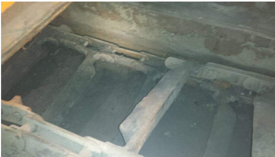
Rysunek 16.5. Układ podawania węgla – przykład uszkodzonego zgrzebła i ślizgów podajnika węgla
