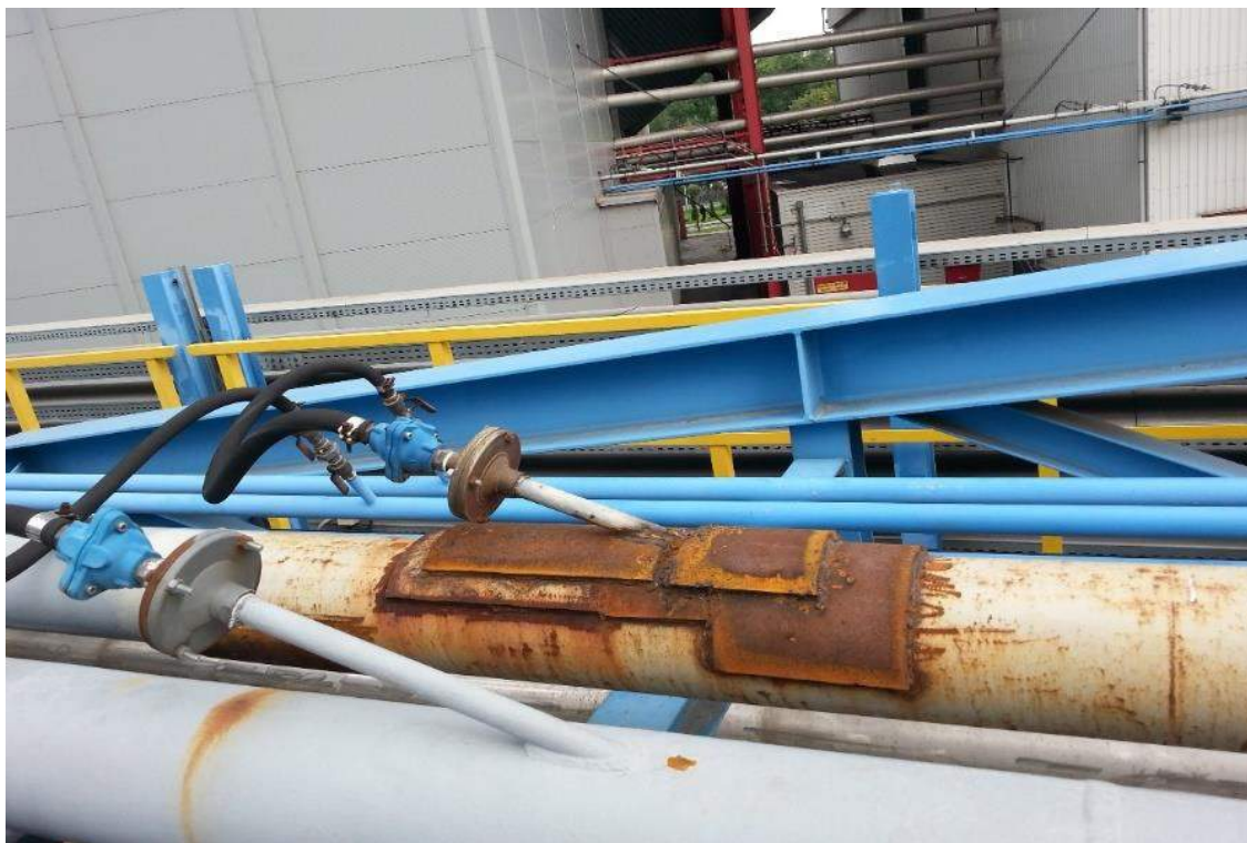
Rysunek 16.12. Instalacja odprowadzania popiołu – wielokrotnie naprawiane uszkodzenia erozyjne
