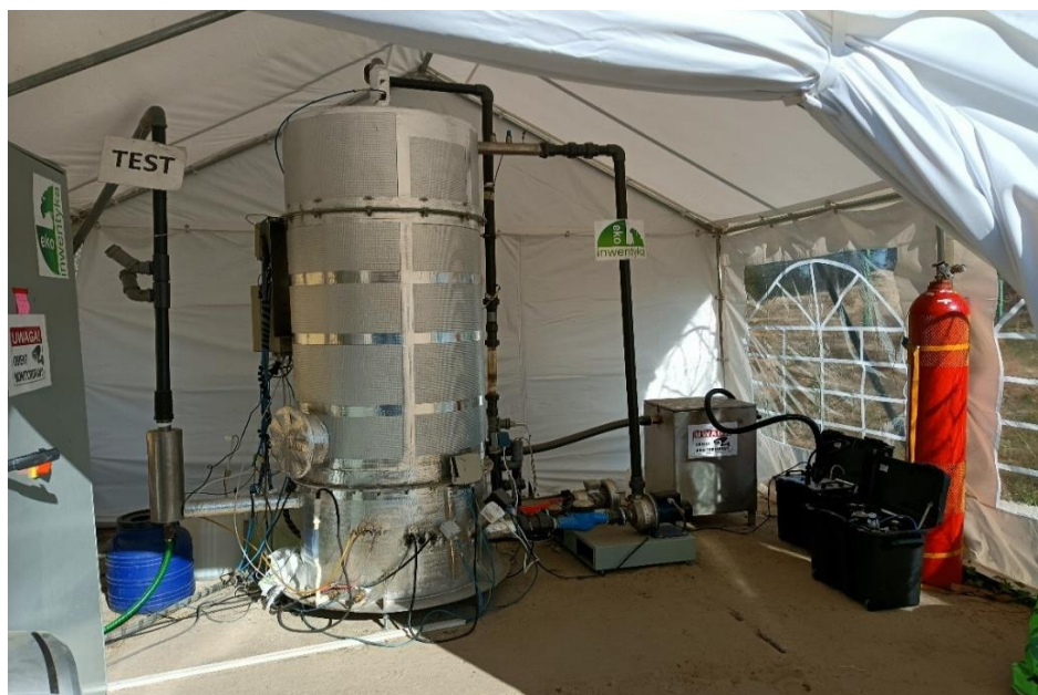
Rys. 26. Pilotażowa instalacja KBT w oczyszczalni ścieków „Tychy-Urbanowice”
