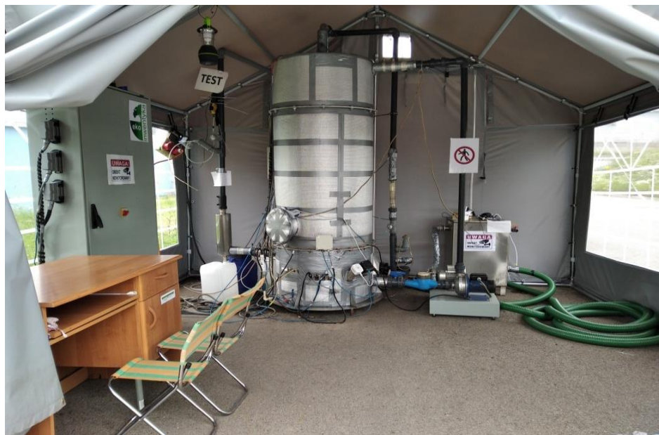
Rys. 19. Pilotażowa instalacja KBT w oczyszczalni ścieków "Klimzowiec"
