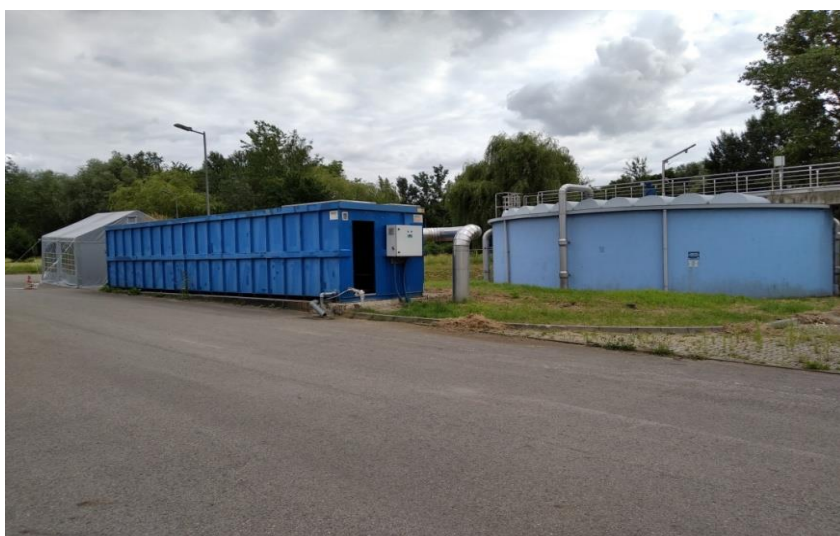
Rys. 15. Biofiltr 042/2 oczyszczający powietrze ze zbiorników osadu nadmiernego, zagęszczonego i przefermentowanego w oczyszczalni ścieków "Klimzowiec"
