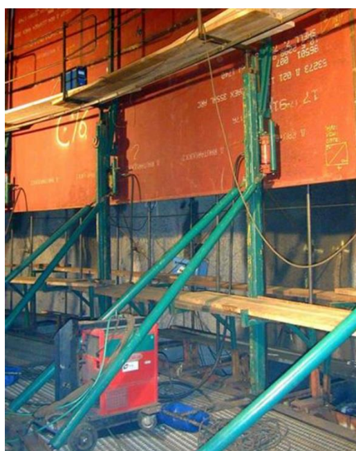
Rys.3.15. Płyty ze stali nierdzewnej, uszczelniające magazyn gazu LRC w Szwecji [4].
