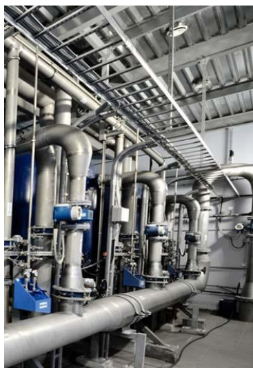
Rys. 2.6. Rurociąg wykonany ze stali 1.4901 [44]
