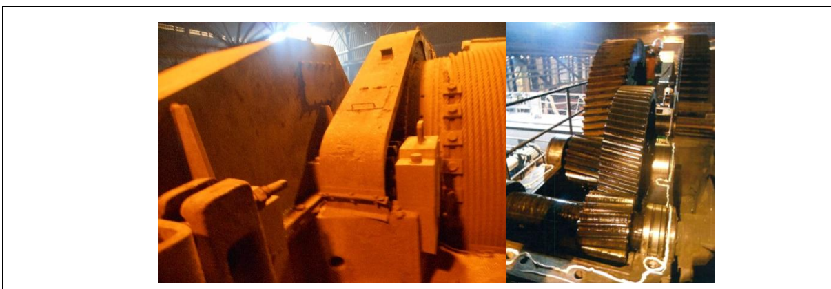
Rys. 38 Widok przekładni mechanizmu widny suwnicy.
