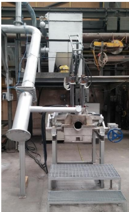
Rysunek 47. Piec elektryczny łukowo–oporowy o mocy 80 kVA wraz z instalacją odbioru gazów.
