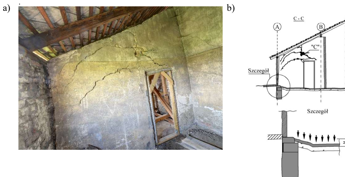
Rys. 7-4. Uszkodzenie „C” ściany znajdującej się między osiami A i B: a) widok uszkodzenia zgodnie z rysunkiem 7-1, b) mechanizm powstawania uszkodzenia, opracowano na podstawie [108]
