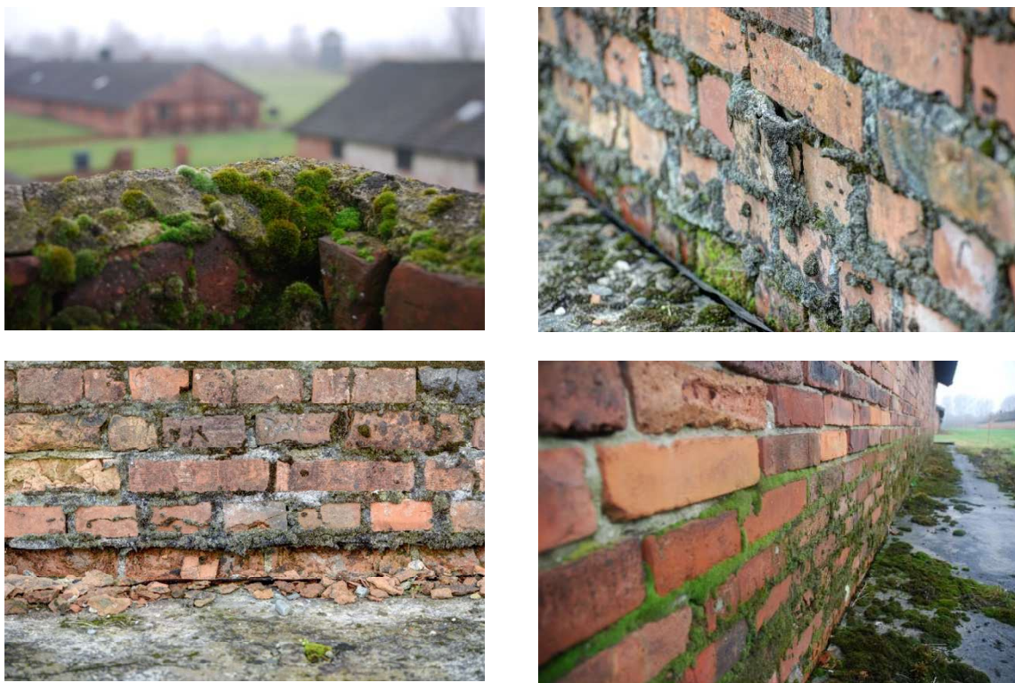
Rys. 7-9. Uszkodzenia cegieł, rozmrożenia, mchy i porosty [108]
