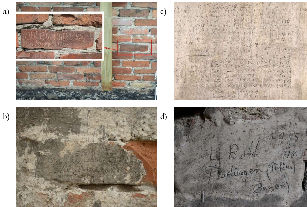
Rys. 7-12. Bezcenne inskrypcje na ścianach wpływające w sposób zasadniczy na postępowanie ze ścianami, na których występują
