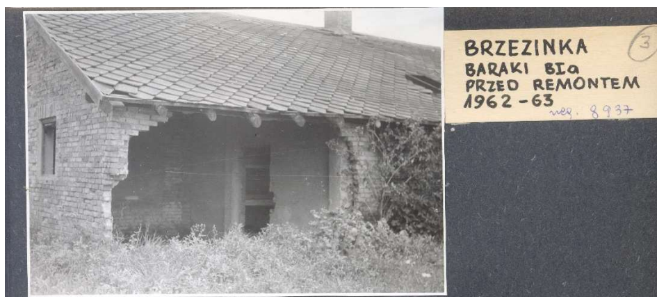
Rys. 2-4. Uszkodzona ściana zewnętrzna jednego z baraków murowanych, odcinek BIa, rok 1963 [5]
