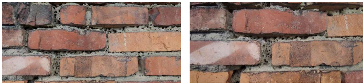
Rys. 7-10. Mechaniczna erozja spoiny [108]
