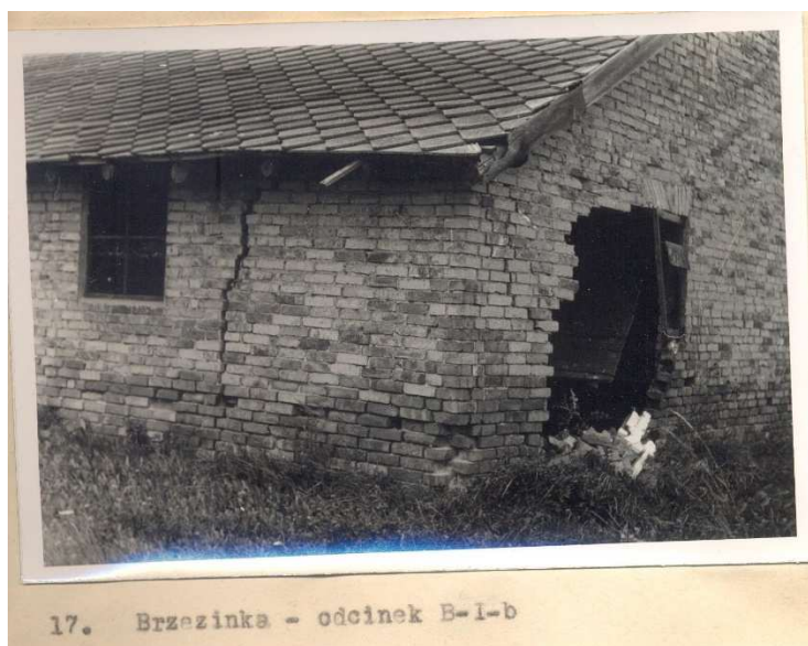
Rys. 2-5. Uszkodzona ściana zewnętrzna jednego z baraków murowanych, odcinek BIb, rok 1958 [5]
