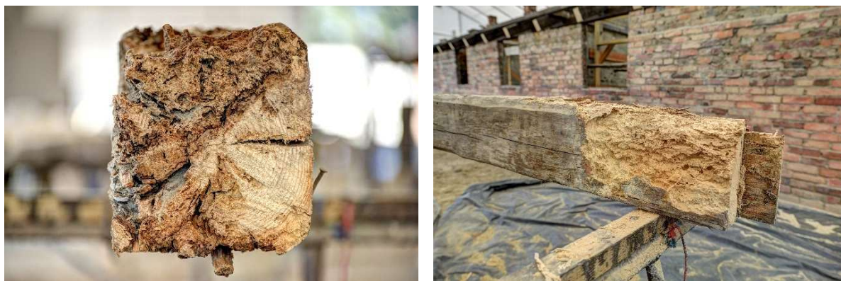
Rys. 6-13. Stan zachowania drewnianej wtórnej belki tramowej – barak B-139
