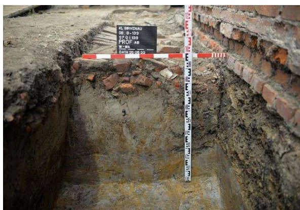
Rys. 4-16. Uszkodzona warstwa cegieł po usunięciu betonowej opaski.
