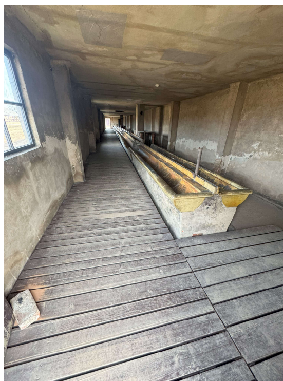
Rys 5-6. Posadzka zastępcza (drewniana – tymczasowa) barak B-87 (umywalnia)
