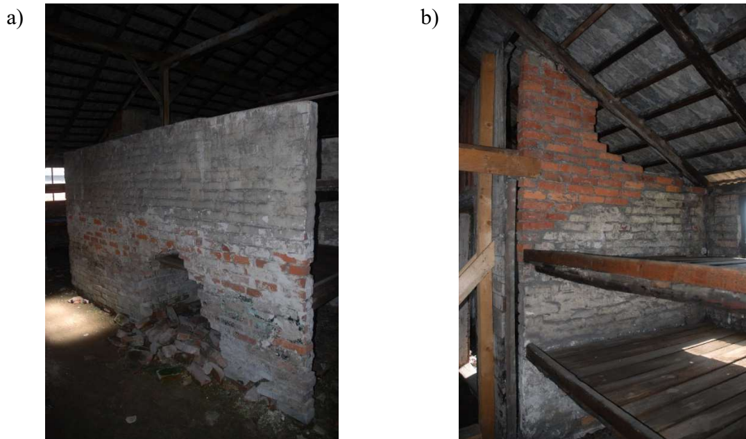
Rys. 7-19. Przykłady uszkodzeń ścian wewnętrznych w baraku B-124: a) utrata stateczności fragmentu ściany wskutek osiadania fundamentu, b) przemurowany fragment ściany działowej przy swobodnej, niepodpartej krawędzi
