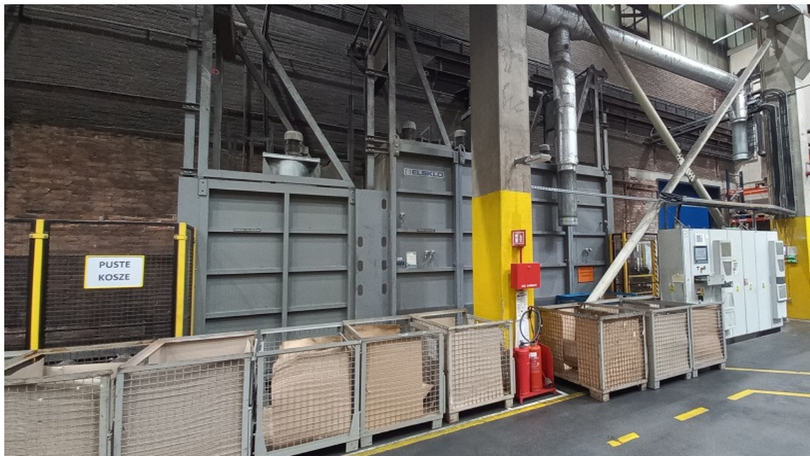
Rys. 2.17. Piec do obróbki cieplnej w spółce MCP – etap T2F2.
