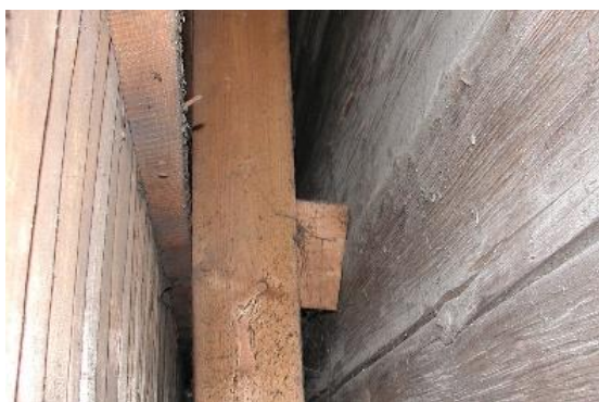
Rys. 147. Widok fragmentu wtórnej konstrukcji szkieletowej dostawionej do północnej ściany nawy. Fotografia: J. Hulimka, 2008 r.
