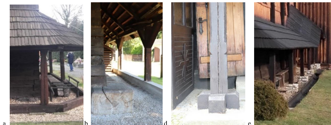
Rys. 101. Przykładowe posadowienie słupów wspierających zadaszenia sobót: a. Cieszowa: słupy sobót ustawione na podwalinie (2019) b. Grzawa: ustawienie słupów na wtórnym betonowym fundamencie (2018), c. Jankowice Rybnickie: ustawienie słupów na drewnianych krzyżakach położonych na wtórnych betonowych stopach fundamentowych (2021), d. Koszęcin: słupy sobót postawione na murowanych z kamienia stopach fundamentowych (2019). Fotografie własne
