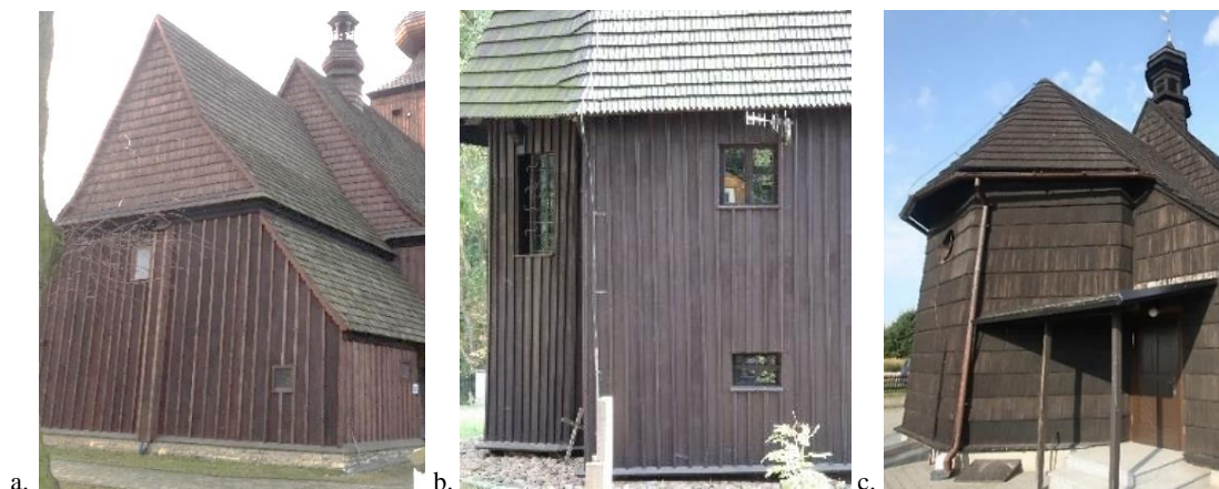
Rys. 77. Przykładowe szalowanie zewnętrznych ścian kościoła: a. Ćwiklice – osłonięcie konstrukcji wschodniej ściany prezbiterium listwami oraz gontem (2018), b. Jakubowice – oszalowanie konstrukcji ścian prezbiterium wraz z olistwowaniem spoin (2020), c. Szczepanek – obudowanie wschodniej ściany kościoła gontem (2019). Fotografie własne
