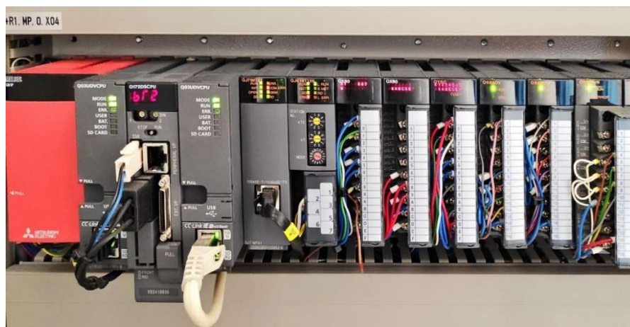
Rys. 4.3. Sterownik PLC firmy MITSUBISHI ELECTRIC
