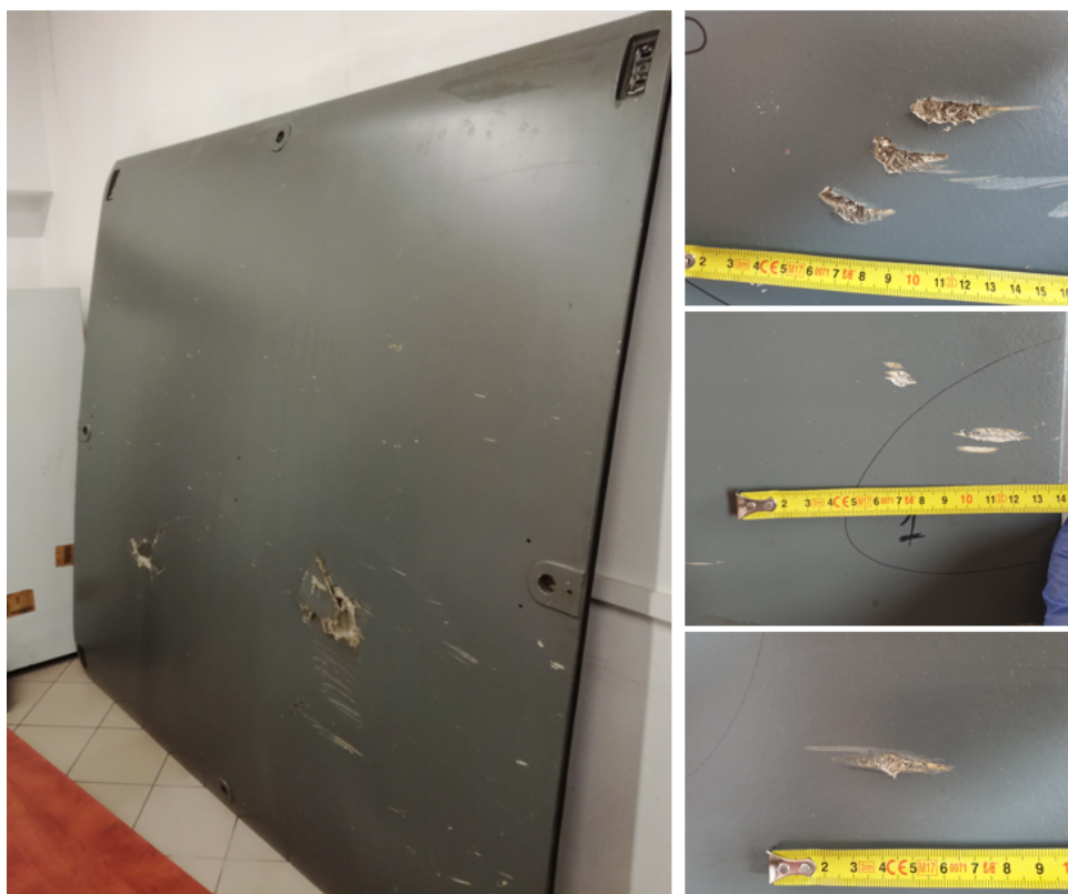
Rysunek 10: Osłona z elektrycznego zespołu trakcyjnego wycofana z eksploatacji z powodu licznych uszkodzeń erozyjnych i perforacji. Po prawej stronie szczegółowy widok przykładowych uszkodzeń wraz z wymiarami
