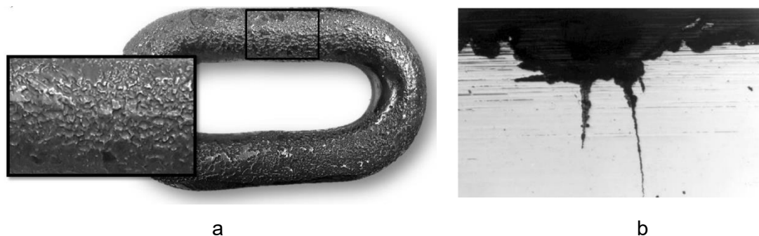
Rys. 2.3 Korozja ogniw łańcuchowych; a – wżery powierzchniowe ogniwa pracującego w środowisku silnie korozyjnym, b – przekrój przez strefę wżeru korozyjnego.
