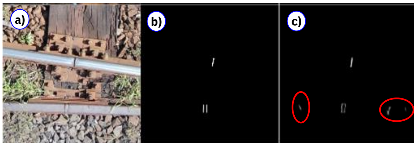
Rysunek 41. Rozpoznane pozorne pęknięcia główki szyny.
