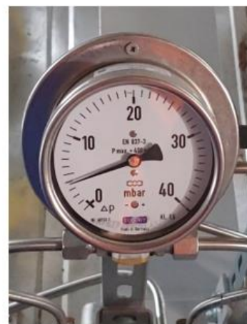
pomiar spadku ciśnienia w trzecim przedziale zgodnie z kierunkiem przepływ spalin
