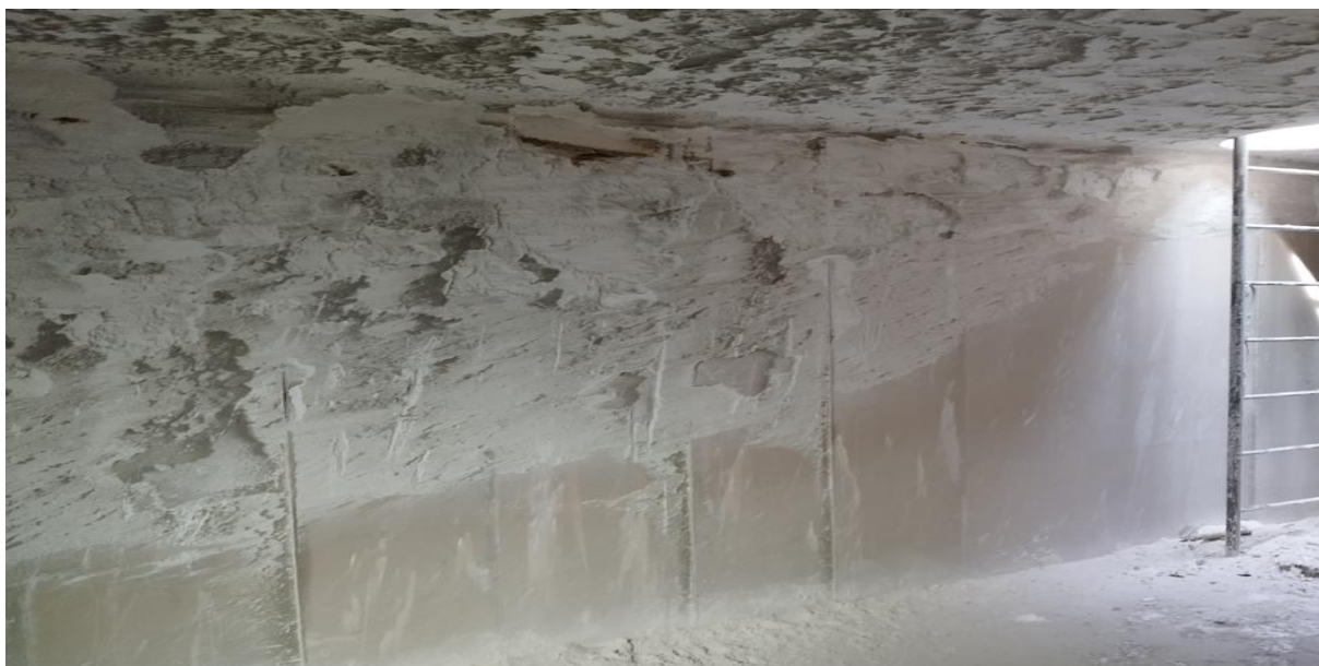
Rysunek 106 Kierunek przepływu sorbentu niesionego przez strugę spalin po podniesieniu lanc dozujących. Widoczne naloty sorbentu na bocznej i górnej ścianie kanału spalin.
