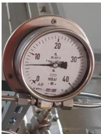
pomiar spadku ciśnienia w drugim przedziale zgodnie z kierunkiem przepływ spalin
