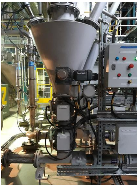
Rysunek 15 System dozowania sorbentu na obiekcie D.
