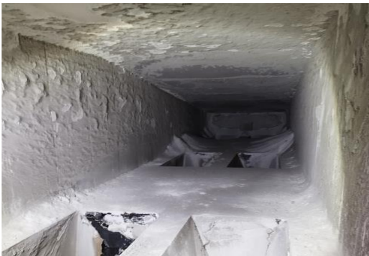
Rysunek 107 Pozostałość usypanego sorbentu w okolicy wlotów do ostatnich na ścieżce spalin przedziałów filtra, będących na końcu kanału wlotowego do filtra workowego.
