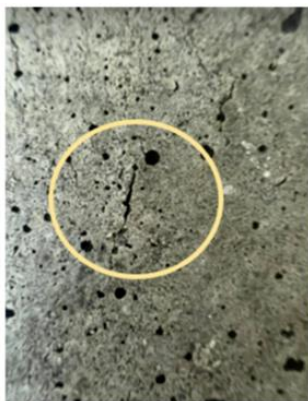
Rys. 1.22. Przykład próbki betonu przedstawiający spękanie
