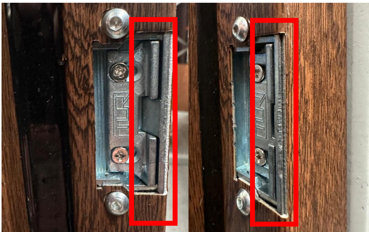
Rys. 44. Zużycie mechanizmu regulacji jęczyczka odpowiedzialnego za zamknięcie skrzydła drzwiowego
