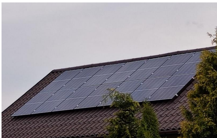
Rys. 27 Widok instalacji PV o mocy 4,83 kWp.
