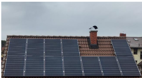
Rys. 24 Widok instalacji PV o mocy 4.65kWp.
