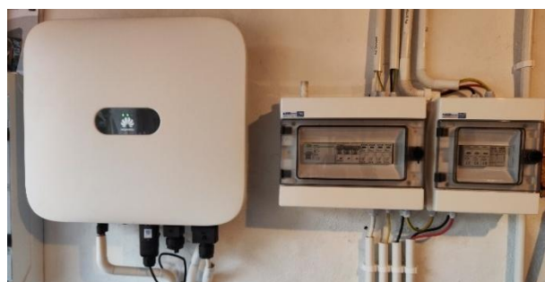
Rys. 25 Widok falownika PV wraz z zabezpieczeniami
