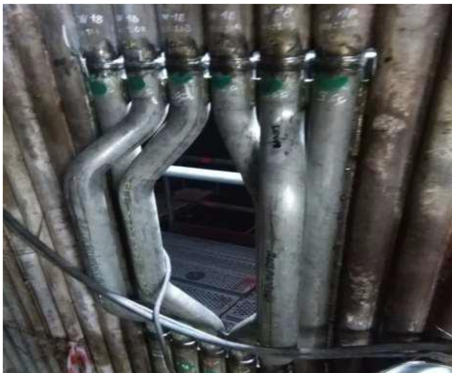
rys. 7. Rury 3R12/4L7 wykorzystane w kotle sodowym w pielni Mondi
