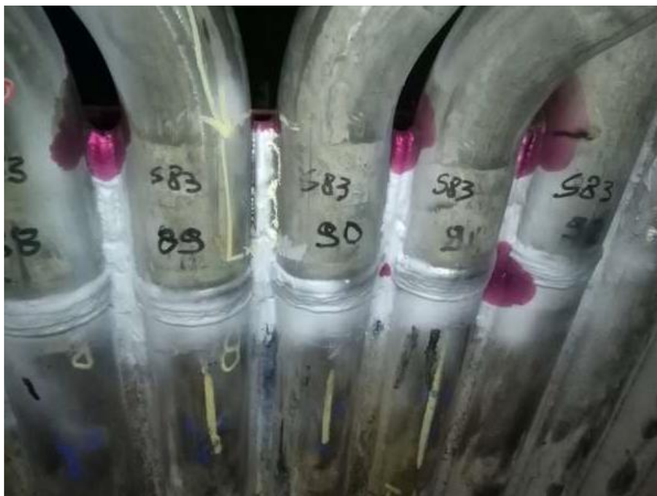
rys. 2. Ściana szczelna kotła sodowego wykonana z rur kompozytowych 3R12/4L7
