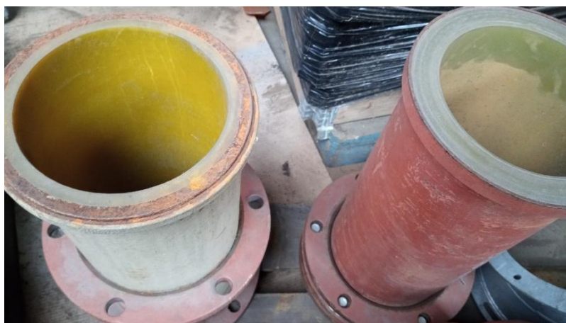
Rys. 13. Widok zdemonutowanych rur z wykładkami z pracującej instalacji transportu hydraulicznego
