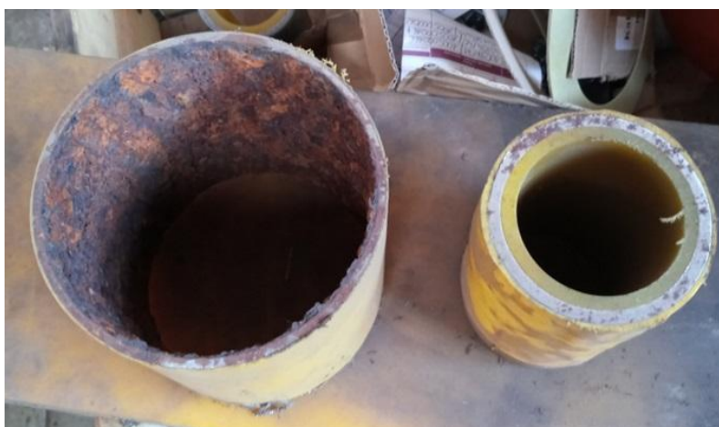
Rys. 12. Widok obrazujący fragmenty rur transportowych wyciętych z pracującej instalacji: po lewej stronie rura stalowa bez wykładki kompozytowej, po prawej stronie rura stalowa z wykładką kompozytową [por. 6]
