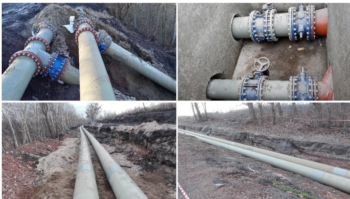
Rys. 1. Widok elementów systemu transportu hydraulicznego zastosowanego na terenie kopalni [por. 6]
