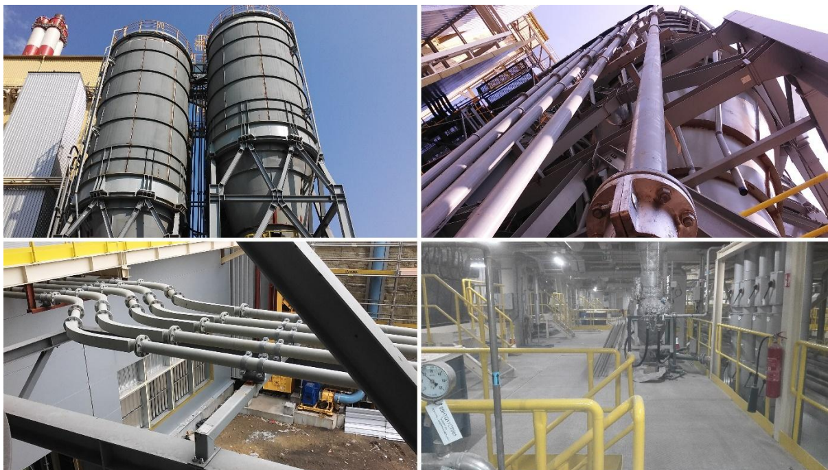
Rys. 2. Widok elementów systemu transportu pneumatycznego zainstalowanego na elektrociepłowni
