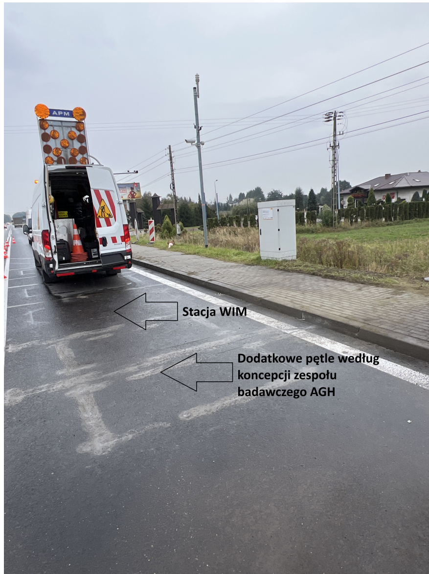
Rysunek 3.6. Stacja WIM + pętle indukcyjne według koncepcji zespołu badawczego z AGH. Źródło: materiały firmy APM PRO
