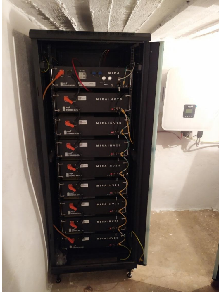
Rys. 4.2. Magazyn energii RESS wraz z ładowarką, zainstalowany w analizowanym budynku mieszkalnym
