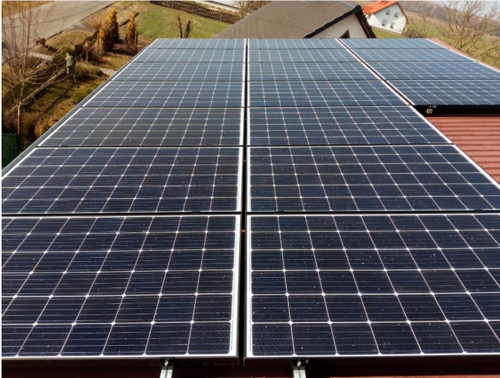
Rys. 4.1. Prosumencka mikroinstalacja PV zintegrowana z analizowanym budynkiem mieszkalnym
