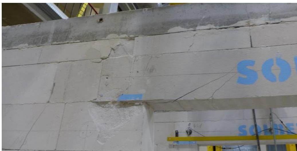
Rys. 7.3.46 Uszkodzenia modeli nieskrępowanych z wypełnionymi spoinami pionowymi: a) MNSO-Z2-1, b) MNSO-Z2-2
