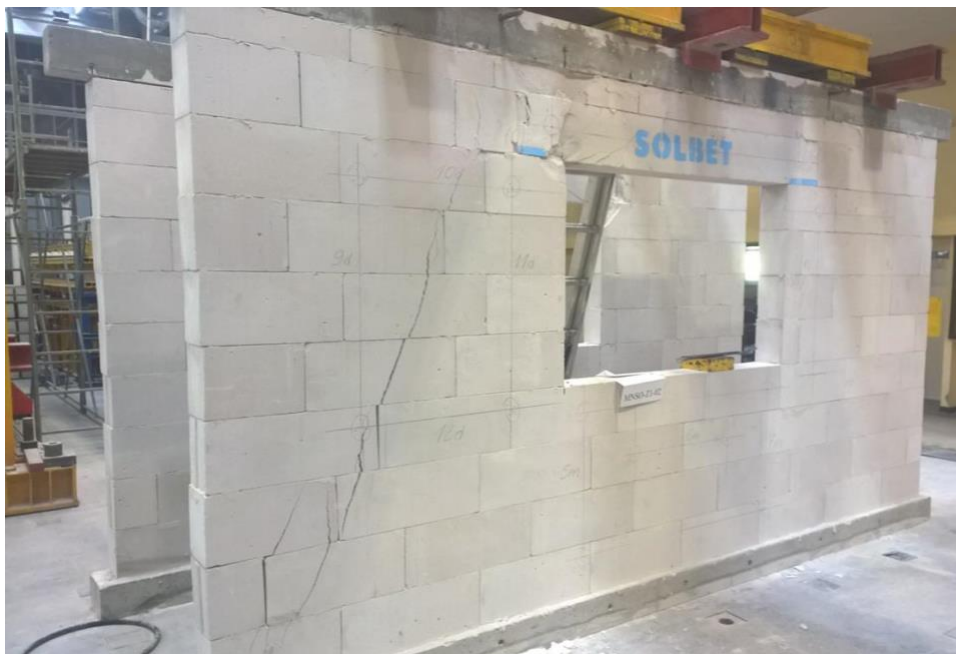
Rys. 7.3.45 Uszkodzenia modeli nieskrępowanych z niewypełnionymi spoinami pionowymi: a) MNSO-Z1-1, b) MNSO-Z1-2
