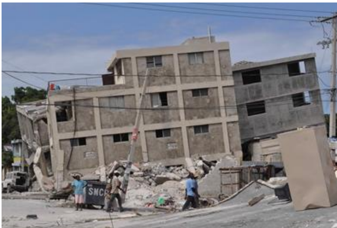
Rys. 4.3.3 Przykład odporności konstrukcji budynku ze ścianami skrępowanymi na obciążenia wyjątkowe (budynek po trzęsieniu ziemi w Haiti w 2010 roku) [W2]
