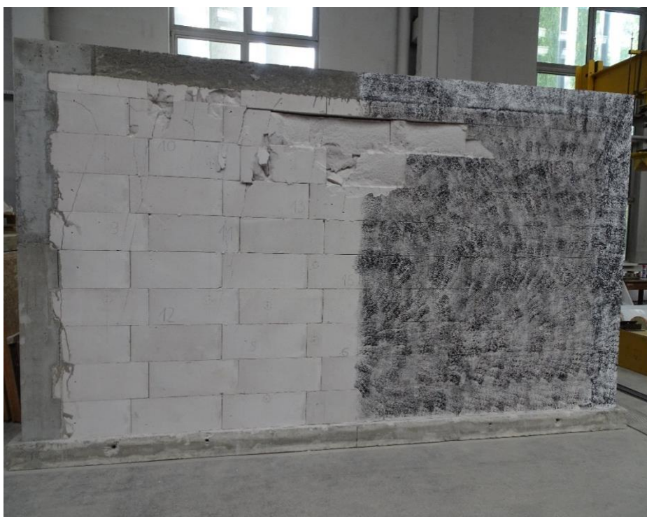
Rys. 7.3.26 Uszkodzenie modeli skrępowanych z wypełnionymi spoinami pionowymi: a) MS-Z2-1, b) MS-Z2-2
