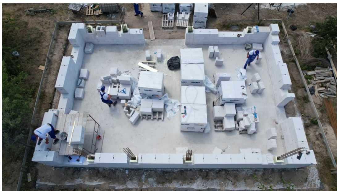
Rys. 4.3.4 Przykład budynku mieszkalnego jednorodzinnego ze skrępowaniem ścian jednowarstwowych z betonu komórkowego (krępujące elementy żelbetowe trzpienie i wieńce są wykonywane w kształtkach U) (fot. Tomasz Rybarczyk)
