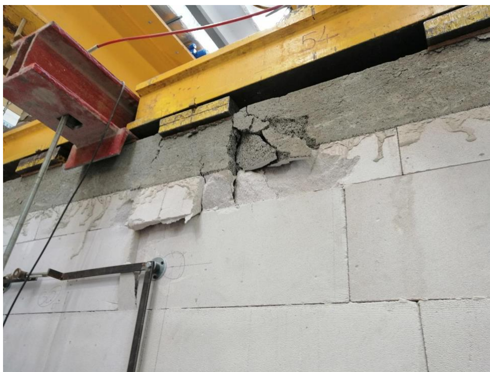
Rys. 7.3.28 Uszkodzenia muru skrępowanego betonem lekkim
