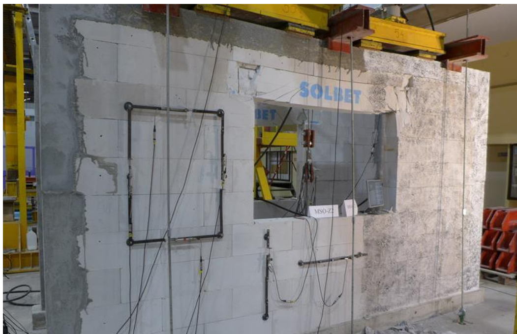
Rys. 7.3.48 Uszkodzenia modeli skrępowanych obwodowo z wypełnionymi spoinami pionowymi: a) MSO-Z2-1, b) MSO-Z2-2
