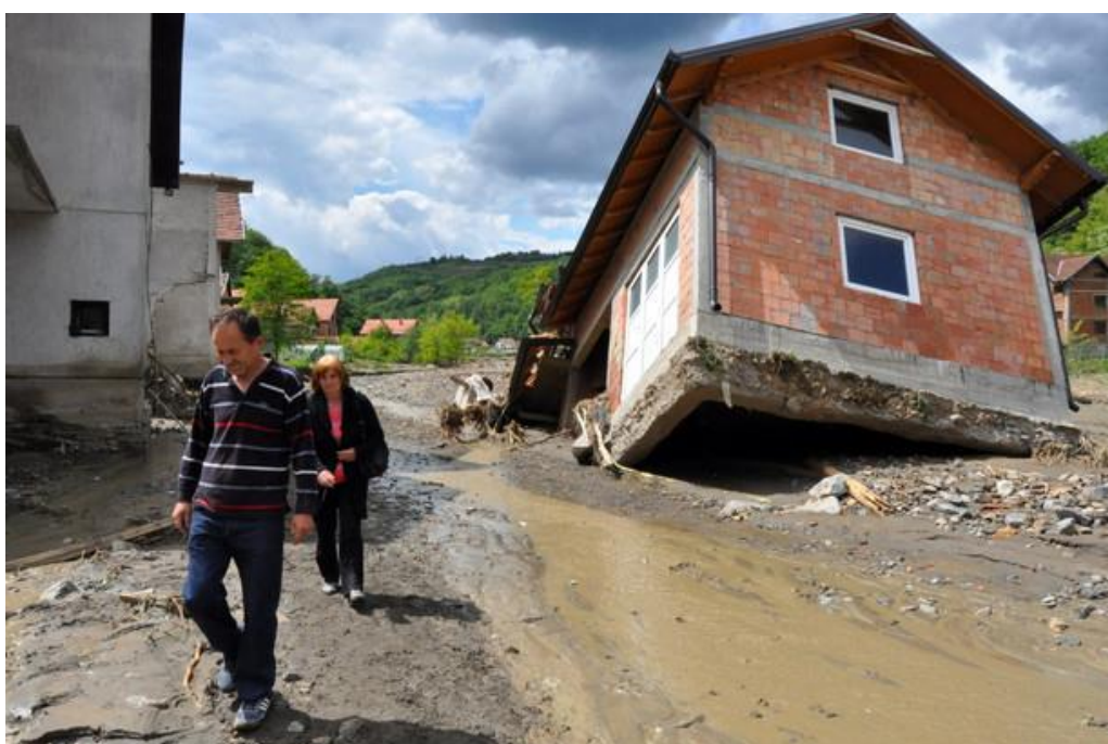
Rys. 4.3.2 Przykład odporności konstrukcji budynku ze ścianami skrępowanymi na obciążenia wyjątkowe (budynek po powodzi w Bośni 2014) [W3]
