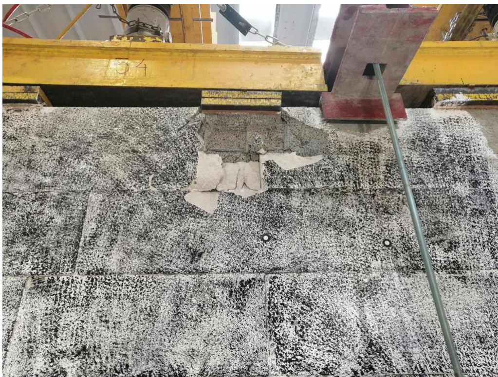
Rys. 7.3.29 Uszkodzenia muru skrępowanego betonem lekkim
