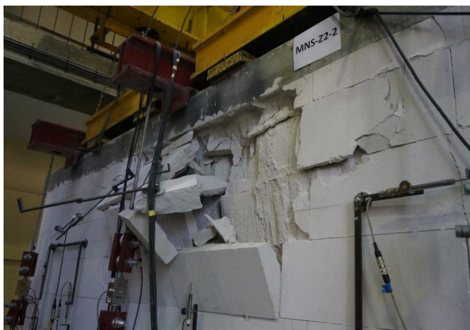
Rys. 7.3.24 Uszkodzenie modeli nieskrępowanych z wypełnionymi spoinami pionowymi: a) MNS-Z2-1, b) MNS-Z2-2
