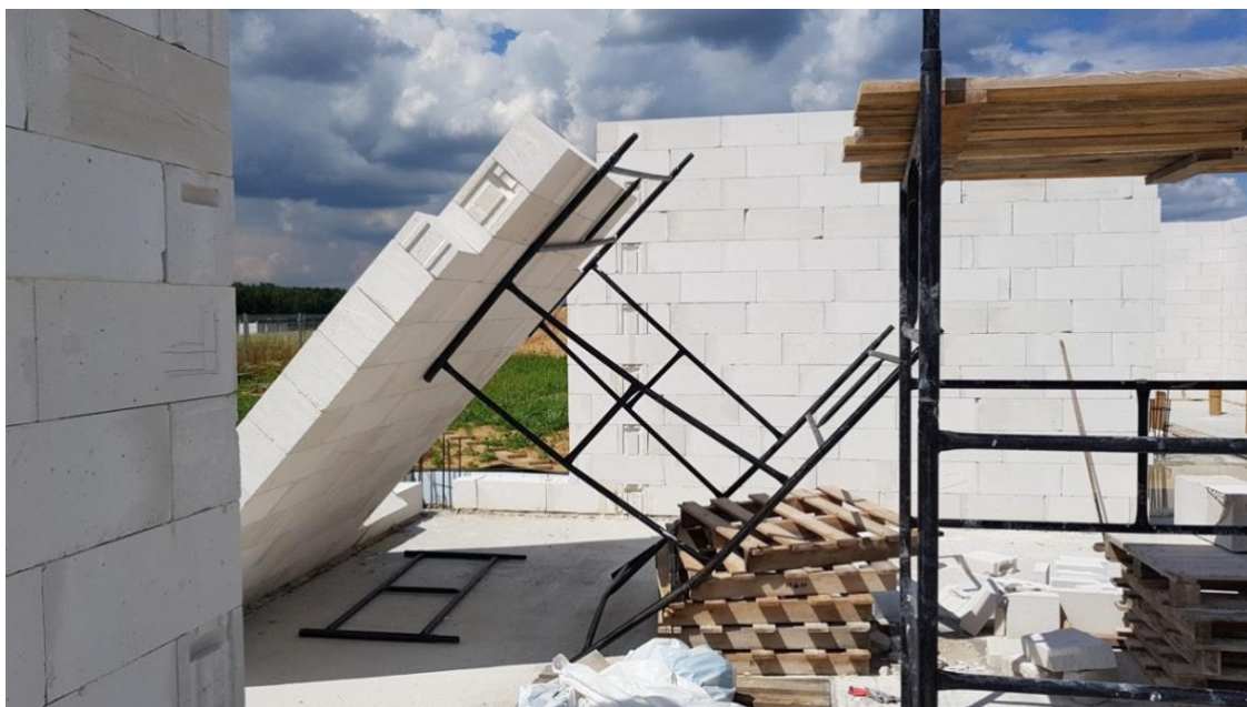
Rys. 4.3.10 Przykład zagrożenia w przypadku wykonywania ścian skrępowanych (fot. Tomasz Rybarczyk)
