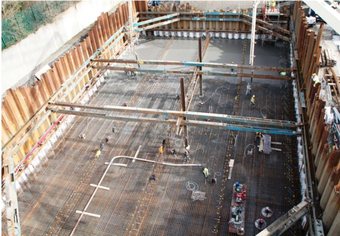
Rys.1.7. Ścianka szczelna rozparta w dwóch poziomach rozporami z profili dwuteowych podpartych pośrednio na stalowych słupach ( https://trenchcontrol.ie )
