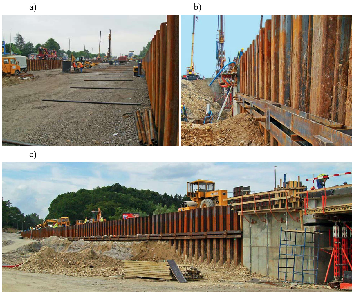
Rys. 1.12. Kraków, ul. Kamińskiego; a) montaż ściągnięć łączących równoległe pograżone ściany z grodzic typu GU16-400, b) oparcie ściągnięć na stalowej belce zamontowanej na grodzicach, c) ściana oporowa w trakcie realizacji; (Kapica i in., 2008).
