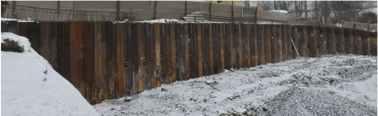
Rys. 4.7. Pograżona i zakotwiona ściana oporowa z grodziec stalowych. Wykop do poziomu platformy, z której wykonywano kotwy gruntowe
