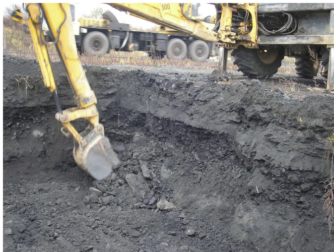
Rys. 5.19. Realizacja wykopu podczas badań terenowych w Piekarach. Widoczne warstwowa budowa podłoża z widoczną dużą zawartością frakcji kamienistej.
